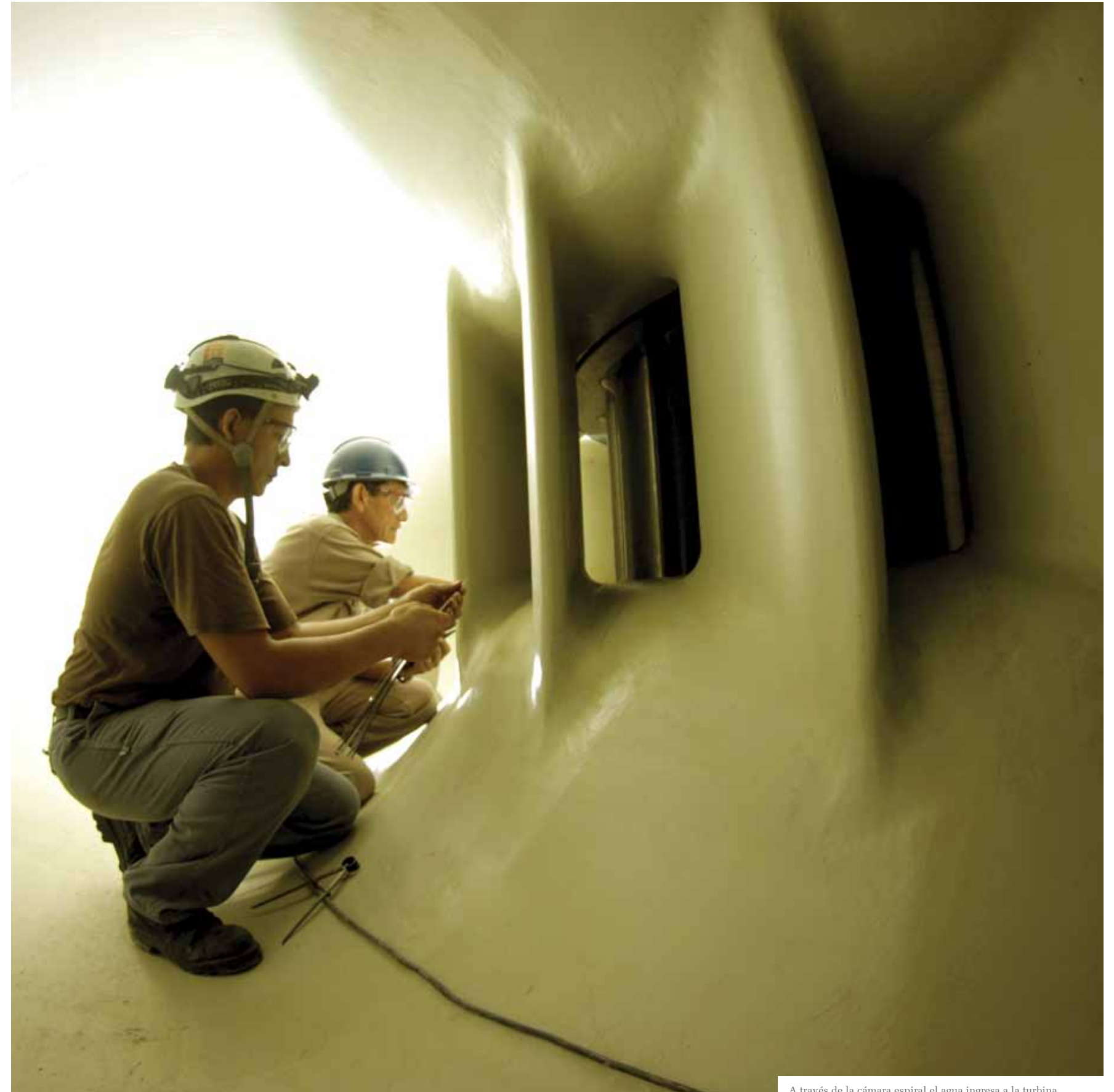
A través de la cámara espiral el agua ingresa a la turbina.
